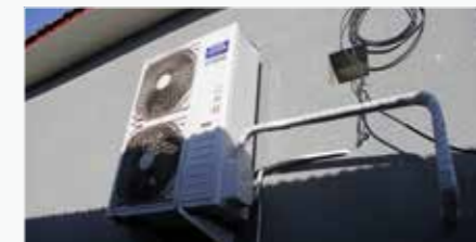
空气源热泵工程案例 北京大兴区
